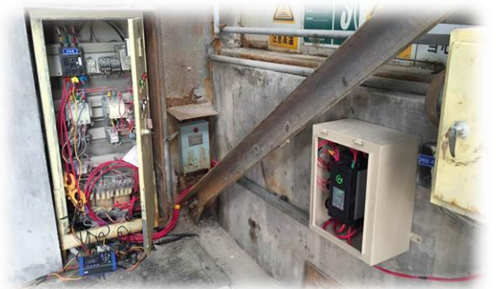
右侧为SGY，替代原自耦降压启动柜（左侧）
